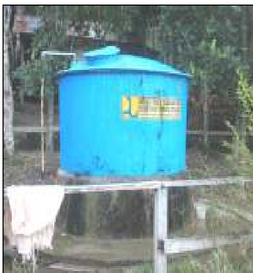
Gambar 4.4. Tandon dari Proyek Air Bersih DPU Kab. Teluk Wondama Sumber: Dokumentasi Peneliti
